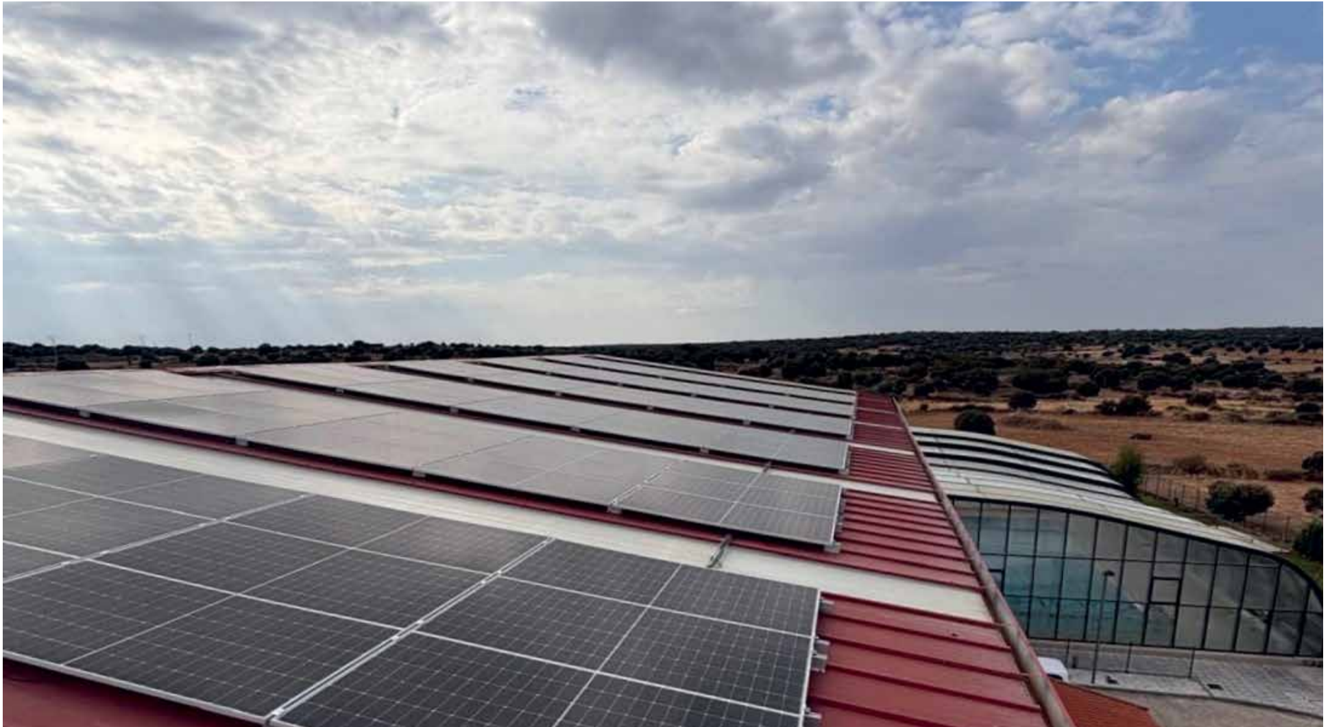
Instalación de placas solares en la cubierta del pabellón polideportivo de Sardón de los Frailes
