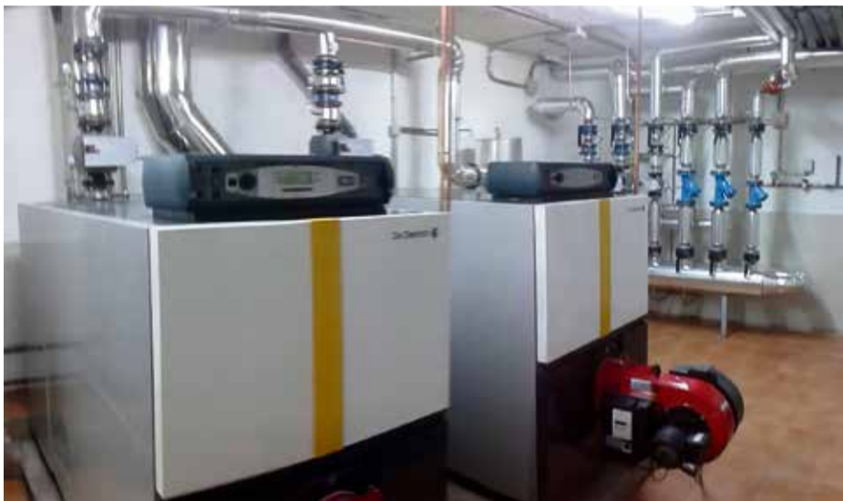
Sala de calderas de un edificio
