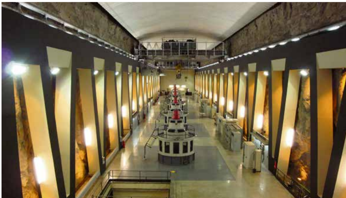
Sala de alternadores de Aldeadávila I
